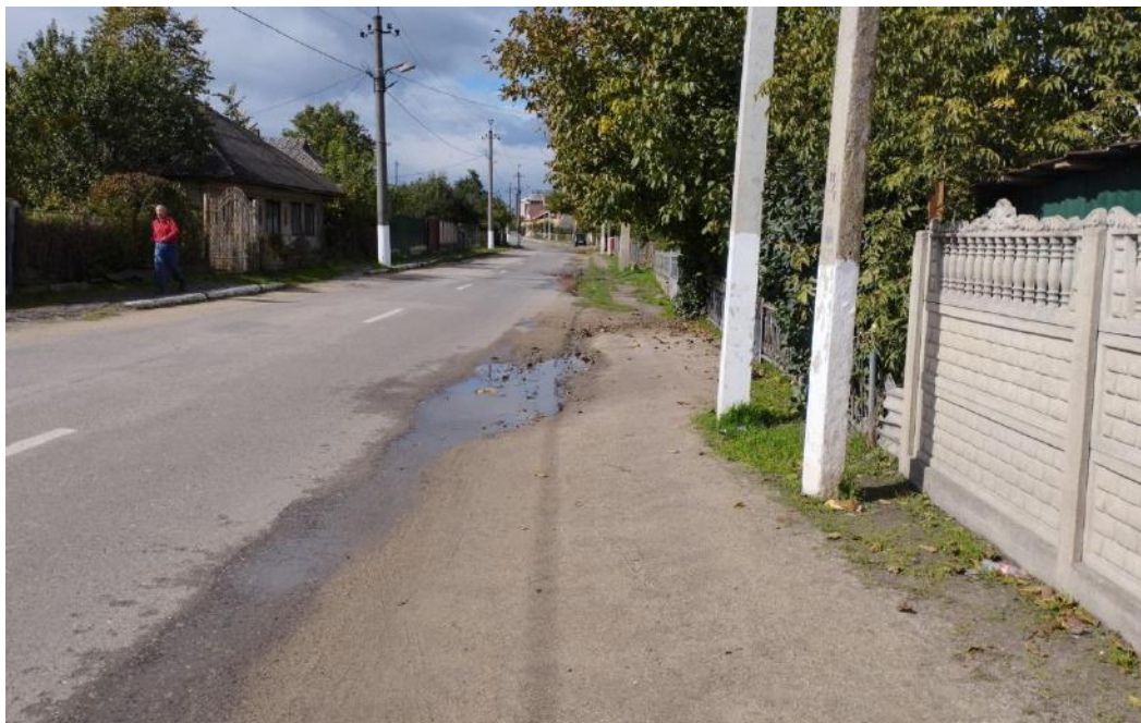
Starea trotuarelor din str. Ștefan cel Mare
